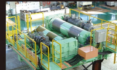
50 / 15t 天井クレーン クラブトロリー
