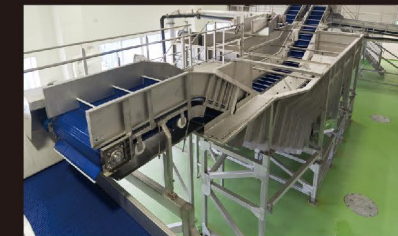
魚体搬送設備 ホッパー、コンベヤー
